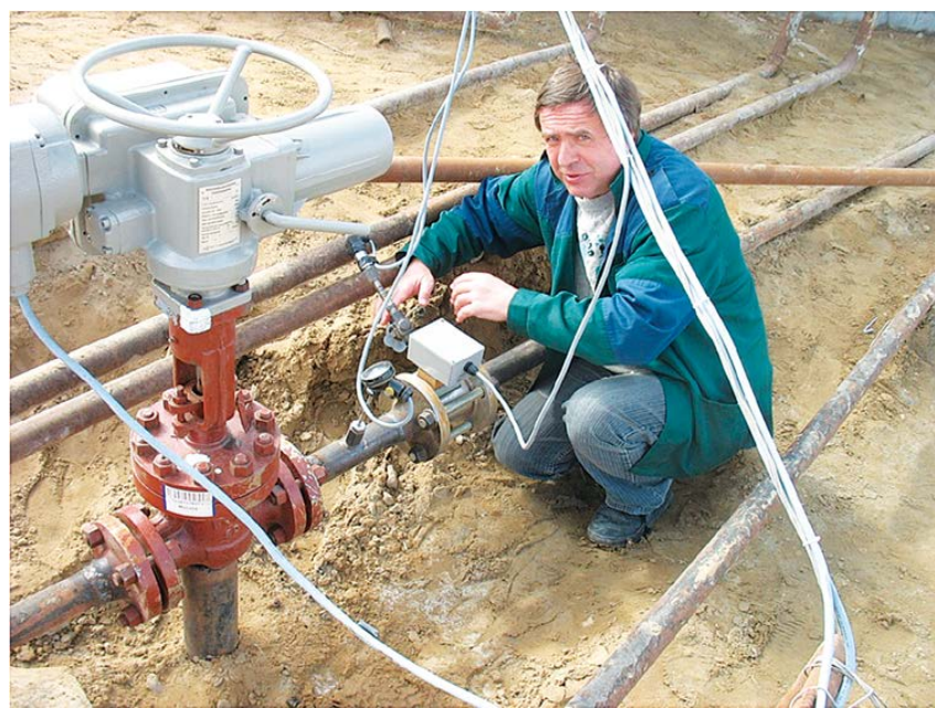
Фото 2 — Монтаж вихревого расходомера «Ирга-РВ». Пустыня Каракумы (Туркмения)
